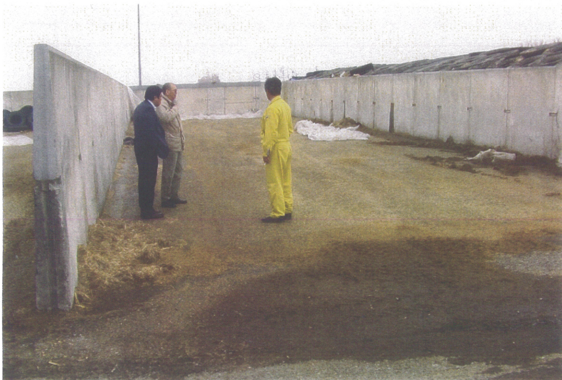
サイレージ損傷状況（幅 9 m 長さ 36m 塀高 2m）
