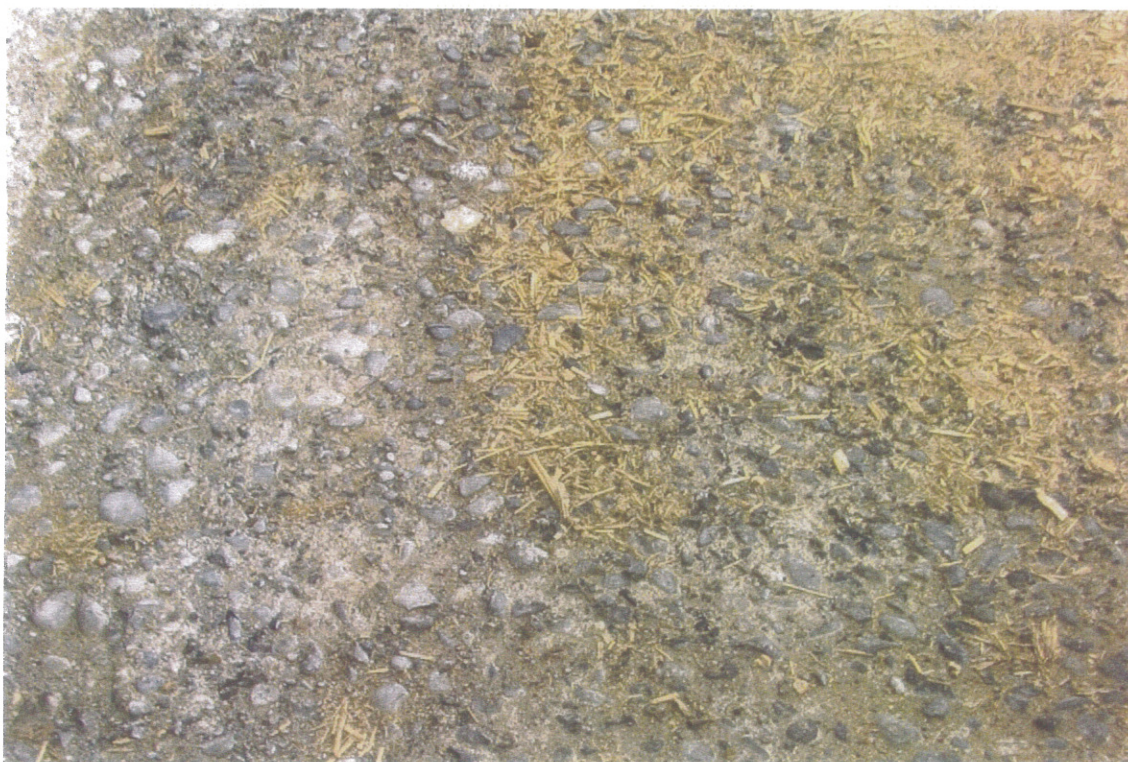
床の損傷状況
