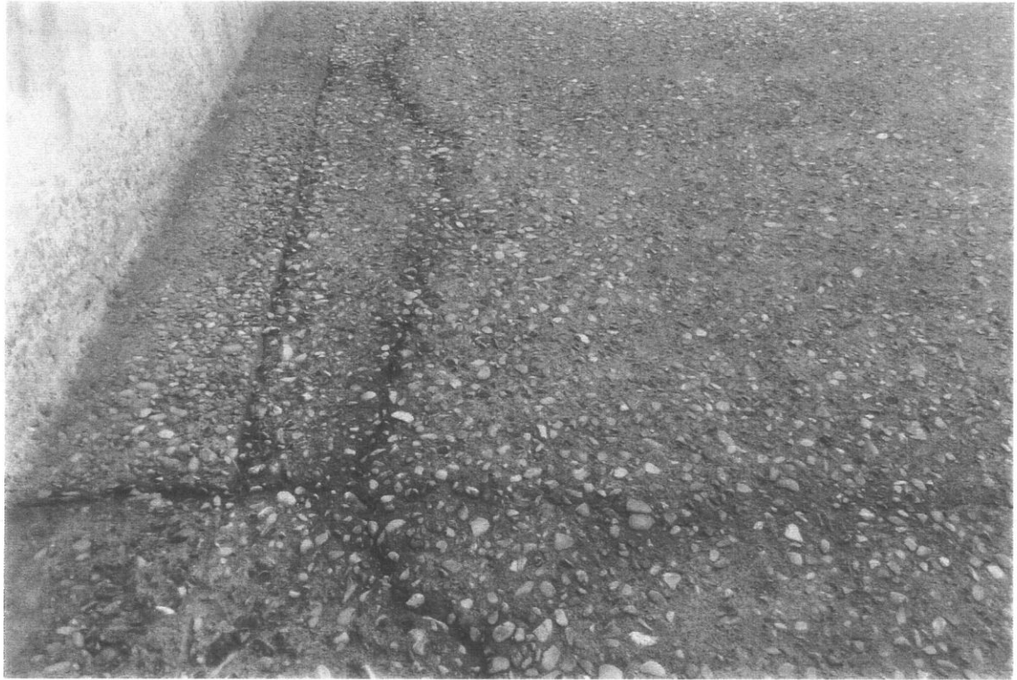
クラック箇所や深溝部分の状況
